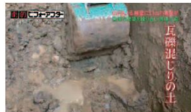
擁壁の中は瓦礫混じりの土さらに地中から水が湧き出ていました。
