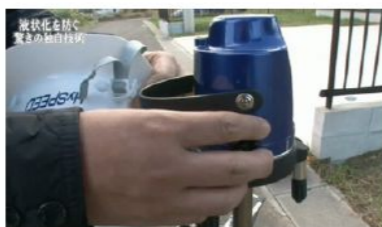
レーザー水平器で砕石パイルを施した住宅の水平を調査
