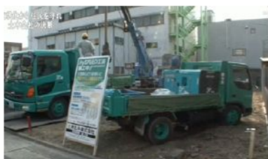
代理店様の現場の様子オリジナルの施工説明看板も作りがばっています。
