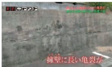
支える擁壁に13mの亀裂が...
